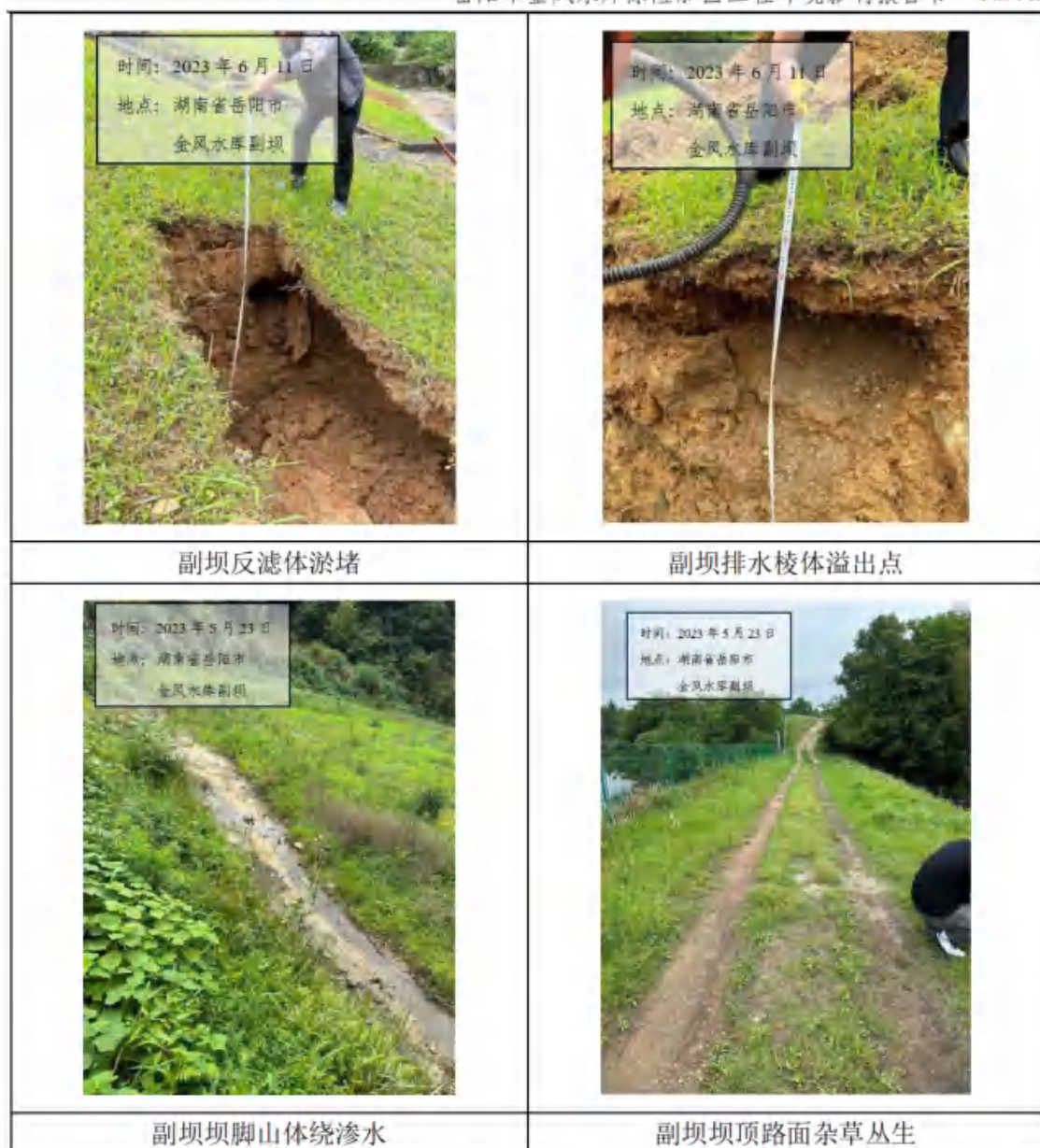
图3.2.5-1 金凤水库大坝现状问题图
